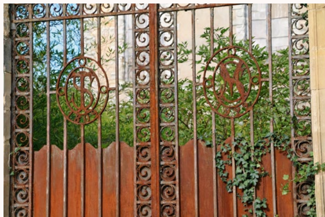
Le portail de l'hôtel particulier est aujourd'hui entièrement rouillé et assailli par le lierre. | OUEST-FRANCE
