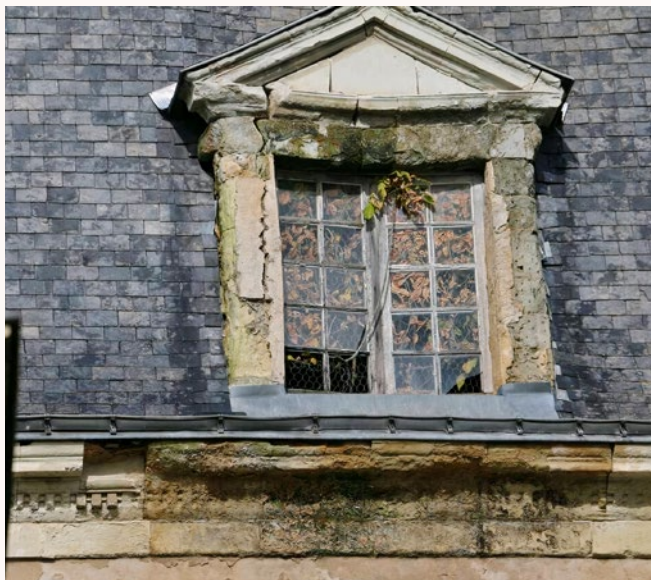
À travers les carreaux des fenêtres cassés, on peut apercevoir que la végétation a pris ses aises jusque dans les étages de la maison. | OUEST-FRANCE
