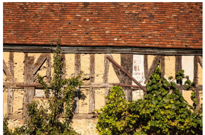
IMAGE 10 – Détail du pan de bois à travers de la Motte à Grées-sur-Roc
