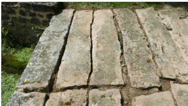
Petit pont du moulin du Bas Possé à Assé-le-Riboul. Certaines dalles ont été reposées cote à cote après avoir été fendues en carrière.
