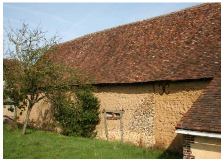
Préval, les Pâtis, façade arrière de la grange-étable en bauge avec renfort en rognons de silex. Cl. Perche Sarthois, 2006.
