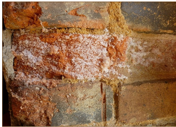
Un mur en briques atteint par le salpêtre
