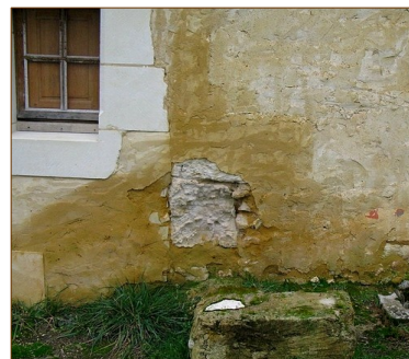
Un enduit trop bas « faisant mèche » et bloc de tuffeau salpêtré
